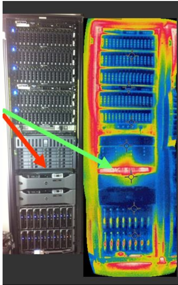
Figure 2 - Cartographie infrarouge d'une baie, la flèche rouge pointe un cache oublié entre 2 serveurs, la flèche verte montre la conséquence du point de vue thermique.
