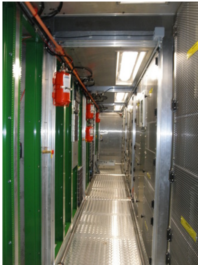
Figure 2 - Vue intérieure de l'allée froide qui donne accès aux faces avant des baies.
