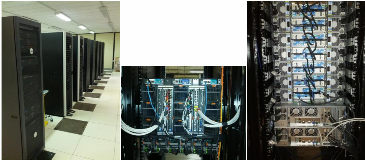
Figure 4 - Matériels mis en œuvre dans le Datacenter DOSI AMU
