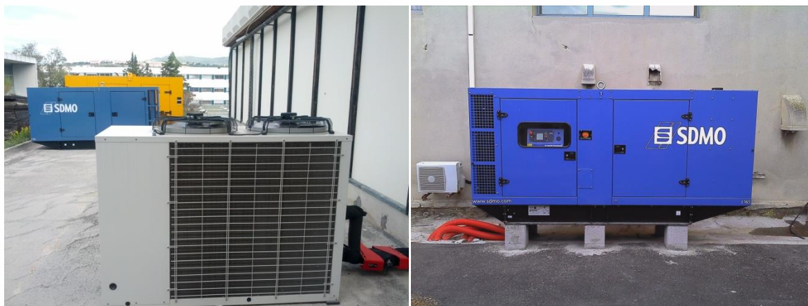
Figure 2 - Une partie de l'infrastructure DOSI AMU
